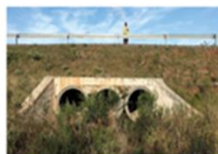
Passagem de fauna subterrânea
